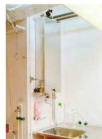
Modulo Pharma-X installato come refrigeratore nel punto di erogazione presso AstraZeneca, Svezia.
